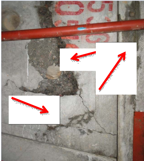
Foto 3 - Desprendimiento del recubrimiento, fisuras y humedad
