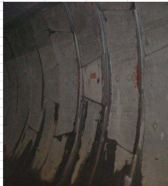
Foto 10 - Filtración por juntas
