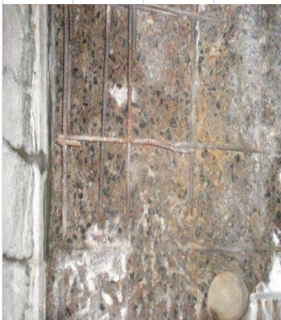
Foto 5 - Desprendimiento del recubrimiento con exposición de armadura de la dovela
