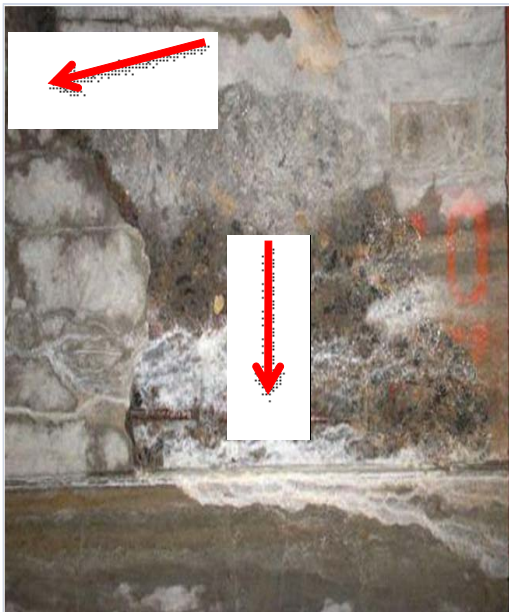
Foto 7 - Desprendimiento del recubrimiento, fisuras, grietas y humedad
