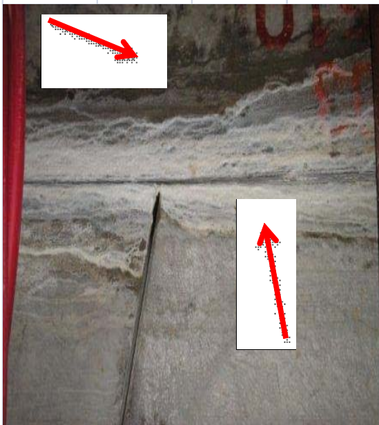
Foto 9 - Filtraciones con exudado y fisuras
