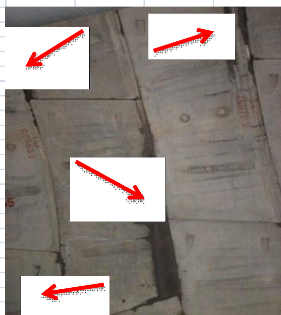
Foto 6 - Fisuras, humedad y partes reparadas
